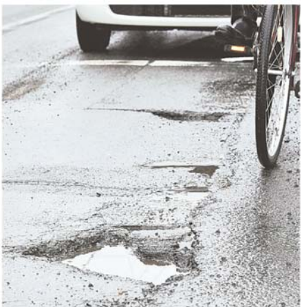
冬の寒暖差などで道路にできた穴。交通に支障が出ている＝8日、盛岡市本町通
